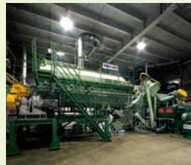
牛脂製造設備
