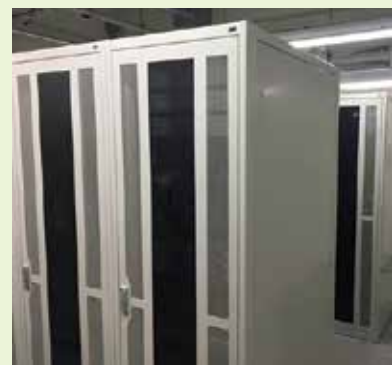
IDC佐世保のサーバラック
