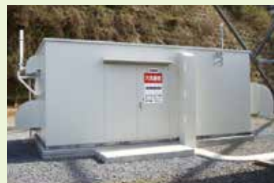
無線機と発電機を一つにして消防法に適合した局舎。ここにも当社の特殊パネルが使用されています。
